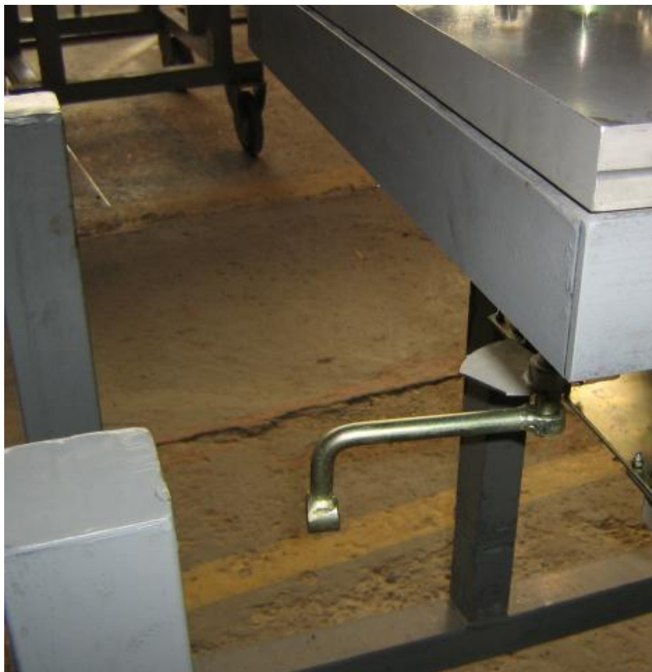
Фото 5. Включение ножей поворотного изолятора
